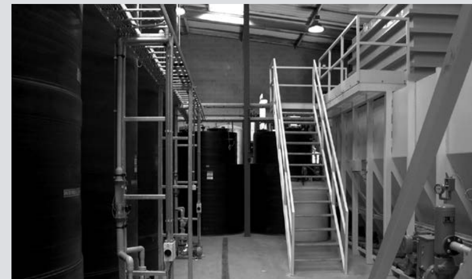
Overzichtsfoto van de buffertanks, reactor en bezinker bij Silac (Frankrijk).
